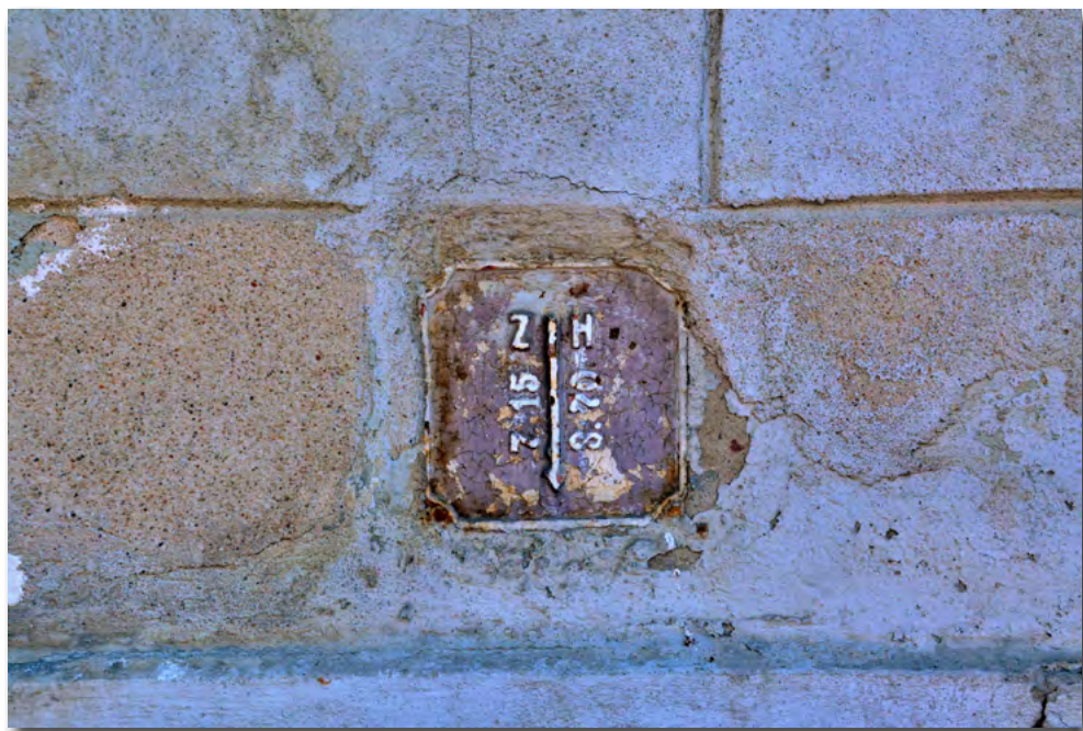
Dawna tabliczka, prawdopodobnie związana z instalacją wodociągową, ul. Podręczna
