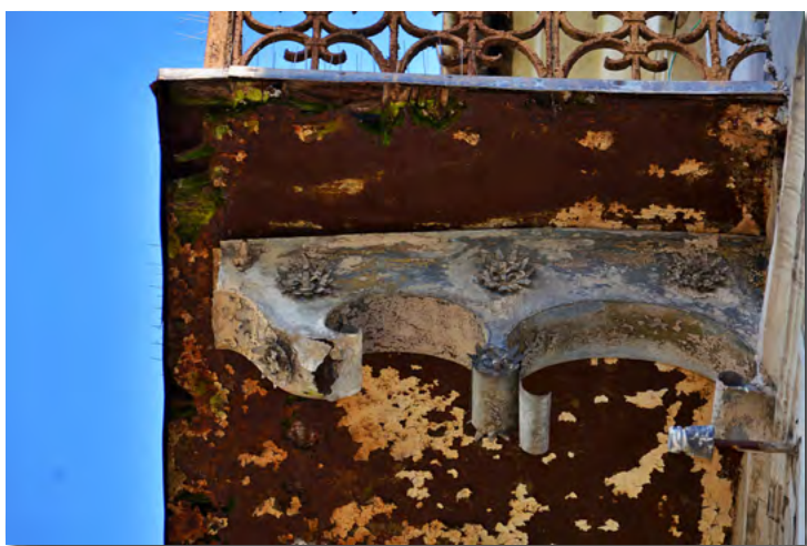
Nietypowa obudowa wspornika balkonowego, plac Piłsudskiego 9
