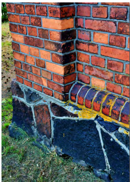
Zbliżenie na szczegóły prac murarskich przy budynku – płaszczyny wypukłe i wklęsłe, kształtki ceramiczne, ul. 29 listopada 57
