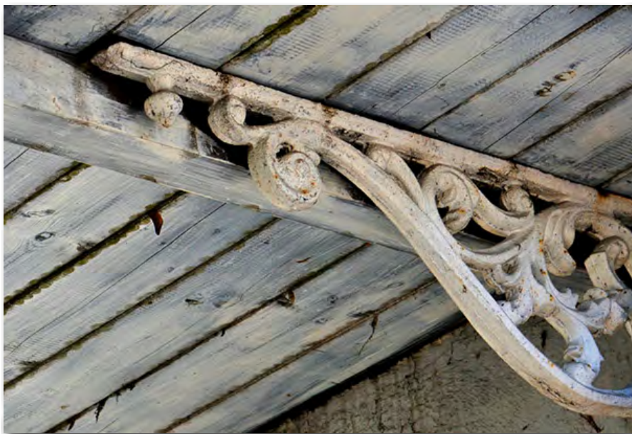
Kamienica przy placu Wolności 4, zbliżenie na wspornik balkonu
